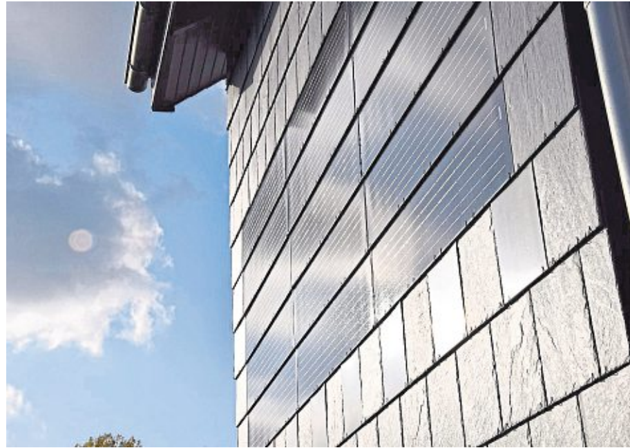
Aus Sonne wird Strom: Die Photovoltaik-Module fügen sich bündig in die neue Schieferfassade ein. Dahinter verstecken sich Wärmedämmung und Versorgungsleitungen.
