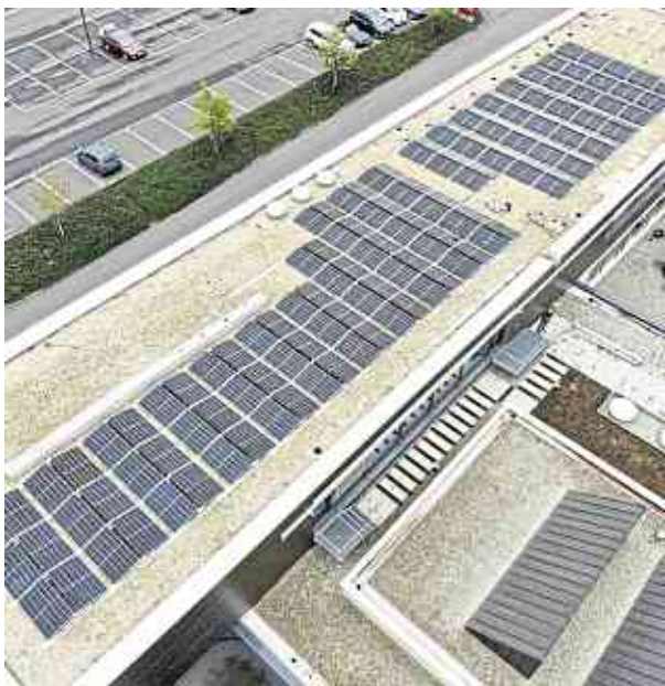
Insgesamt 210 Fotovoltaikmodule mit Solarzellen auf dem Flachdach des Verwaltungsgebäudes installiert, die neu errichtete Anlage erzeugt rund 56 500 Kilowattstunden Strom pro Jahr. Foto: VG Pellenz
