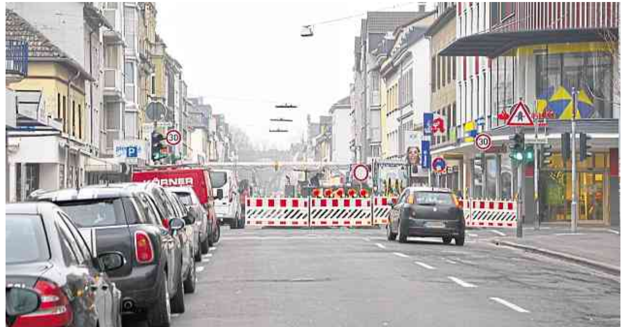
Die Arbeiten zur Sanierung der Marktstraße haben in dieser Woche begonnen. Foto: Schlaf
