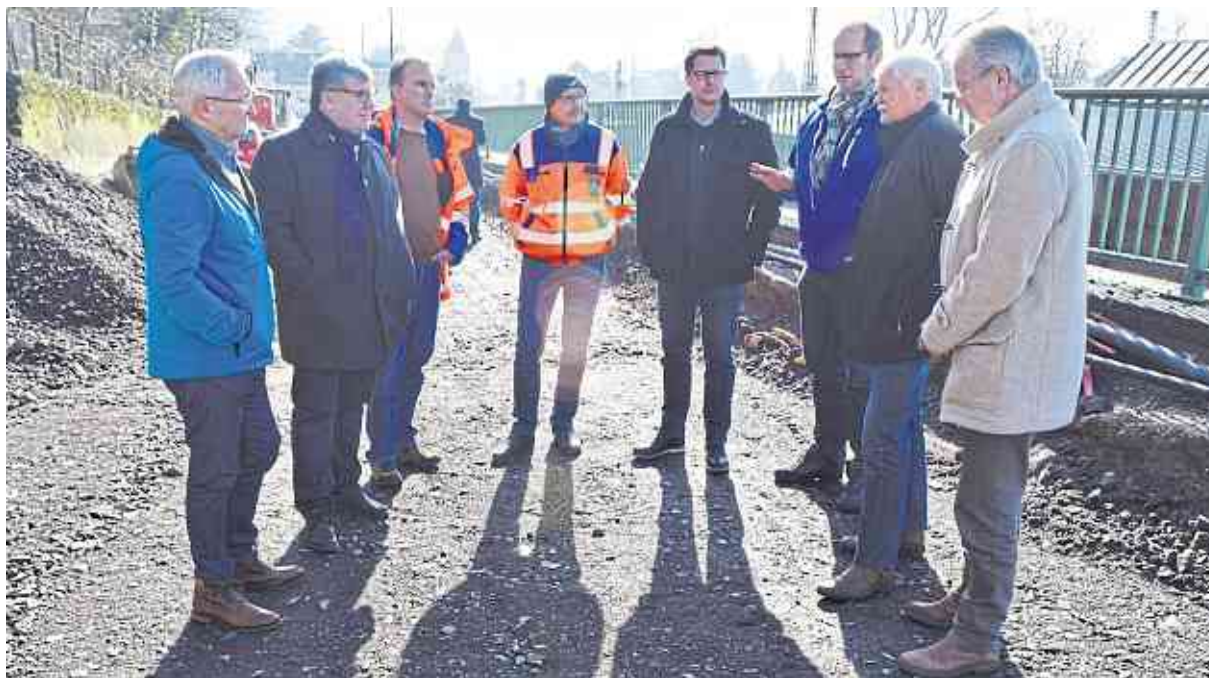
Über den Stand der Sanierungsarbeiten an der Kreisstraße 11 (Rheinhöller) informierten sich Landrat Achim Hallerbach (v. links) und der 1. Kreisbeigeordnete Michael Mahler gemeinsam mit Bernd Cornely, Leiter des LBM Cochem-Koblenz, sowie den Bürgermeistern der Stadt Linz, Hans-Georg Faust (rechts) und der Gemeinde Ockenfels, Kurt Pape (Zweiter v. rechts).
